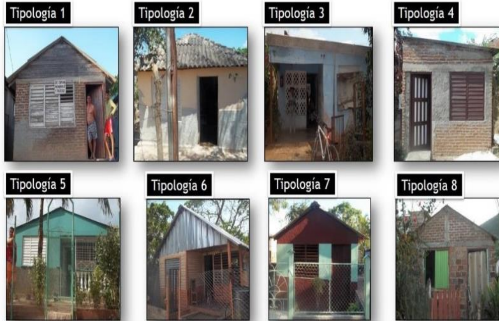
Figura 1.14. Tipologías constructivas predominantes en viviendas con cubiertas ligeras en la ciudad de Holguín (Lengarán, 2015).
