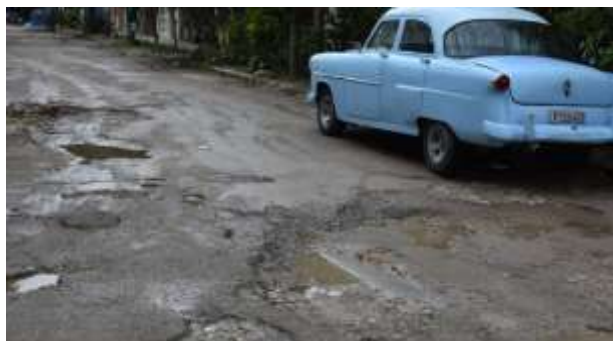
Fig.1.11 Deterioro de las vías en la ciudad de Holguín.
