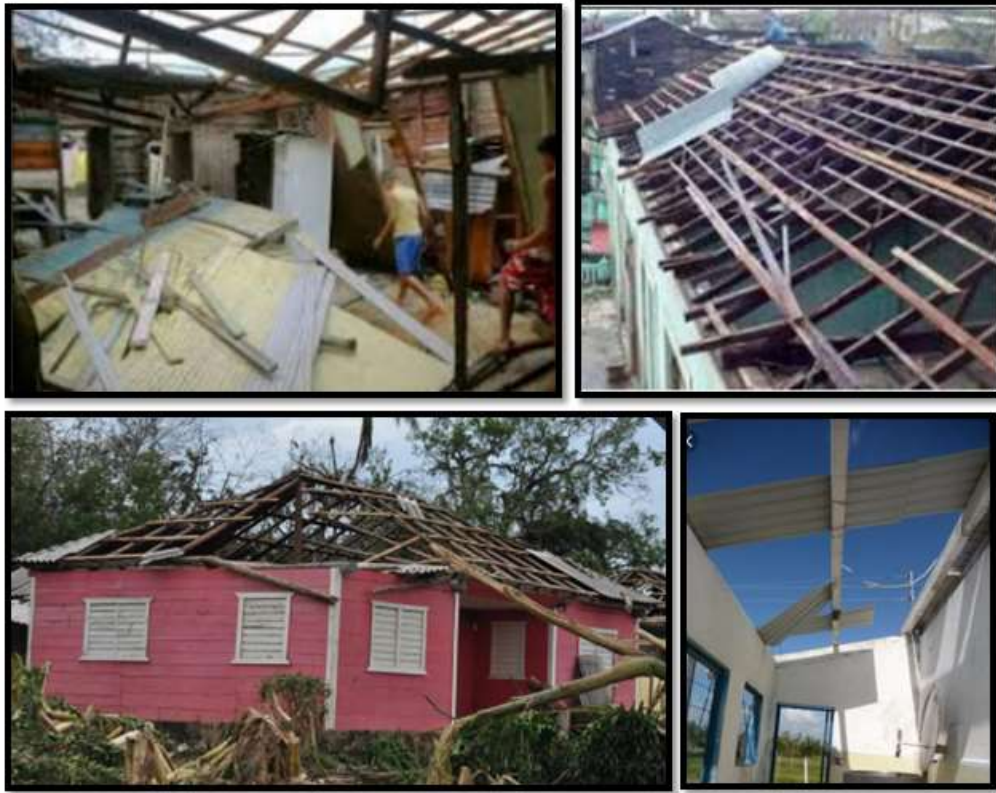
Figura 1.3. Daños en viviendas con cubiertas ligeras tras el paso de huracanes. Fuente: Reyes, 2017.
