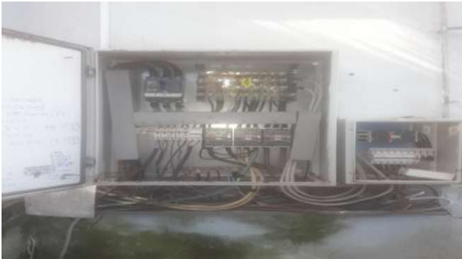
Ilustración 22. Panel general de distribución del Edificio Central.
