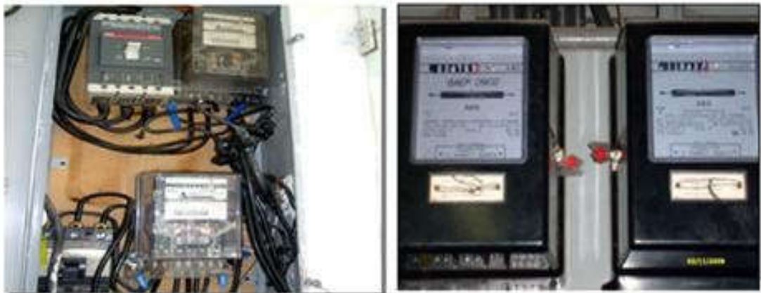
Figura 1.2: Contadores de energía electromecánicos.
