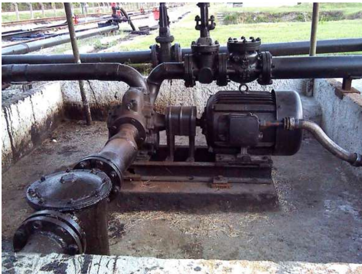
Anexo 9: Fotografía de la bomba de Fuel Oil
