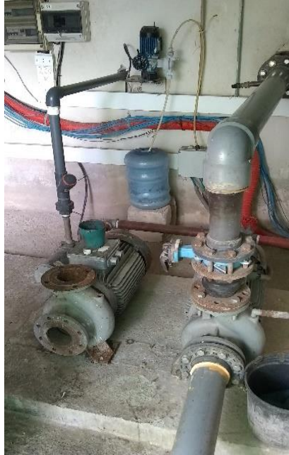
Figura 2.4. Bombas del sistema de bombeo. Fuente: elaboración propia (2018).
