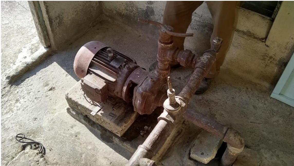
Figura 2.2. Bomba del sistema de bombeo. Fuente: elaboración propia (2018).
