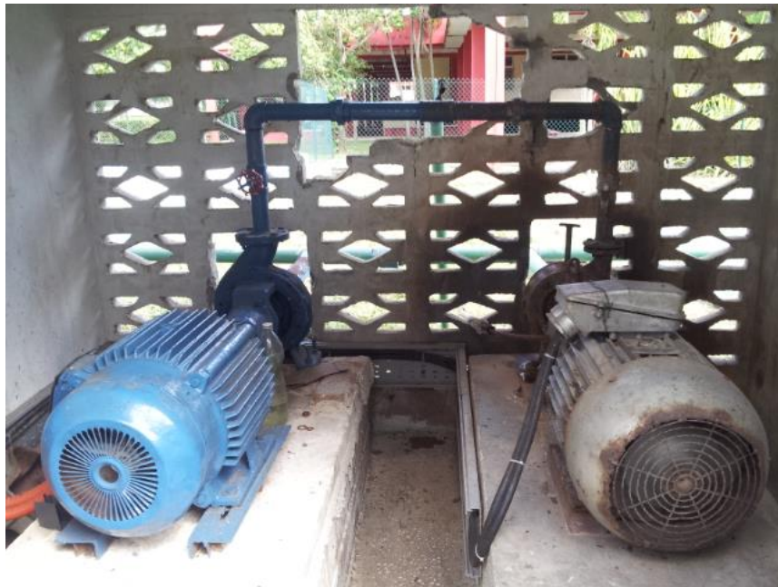
Figura 2.1. Bombas del sistema de bombeo. Fuente: elaboración propia (2018).
