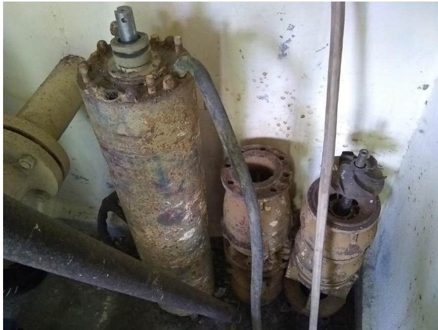
Figura 2.3. Bomba del sistema de bombeo. Fuente: elaboración propia (2018).
