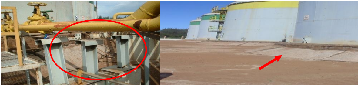
Figura 14 Desplazamientos producidos alrededor de los tanques.
