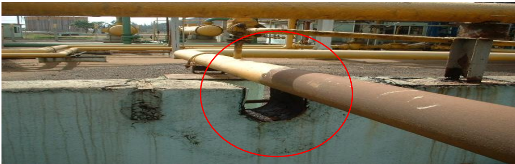
Figura 15 Desplazamientos producidos por el hundimiento del suelo.
