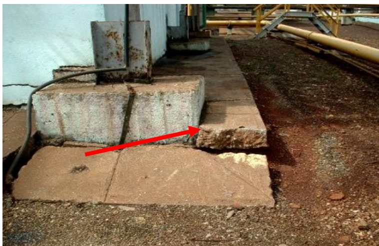
Figura 19 Rotura de la acera y pedestal.
