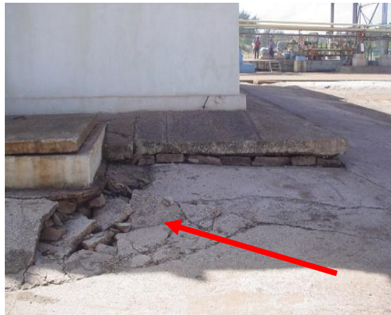
Figura 17 Rotura y voladizo de la acera alrededor de la cimentación
