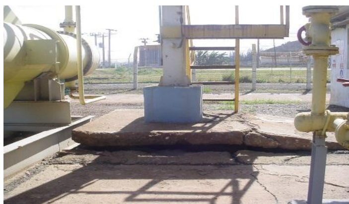
Figura 18 Rotura del piso y aceras por agrietamiento.
