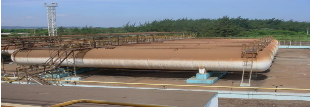
Figura 10 Balas metálicas para el almacenamiento de amoniaco
