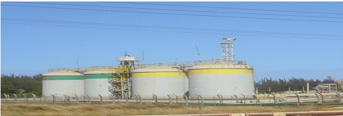
Figura 11 Tanques metálicos, para la preparación de la solución amoniacal
