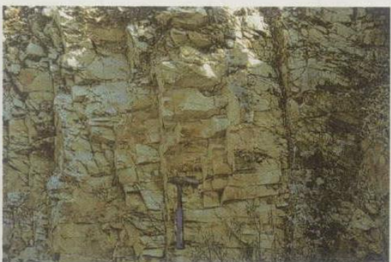
Cuarcitas ordovícicas. Calidad mala. Macizo muy alterado y brechificado.
