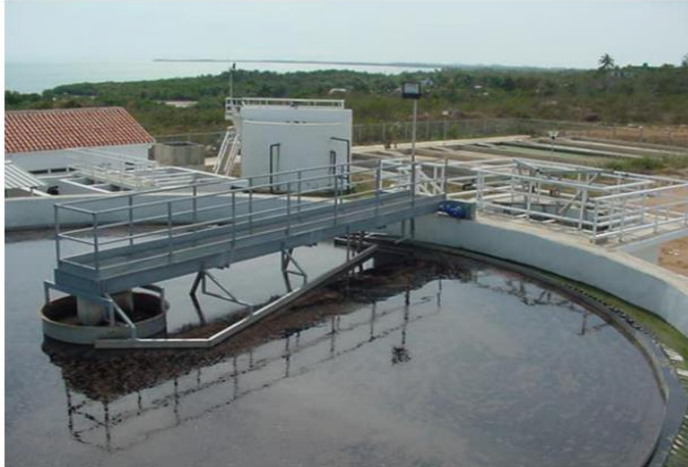
Figura – 9: Tanque sedimentador PTR Punta de Hicacos, Varadero, Matanzas
