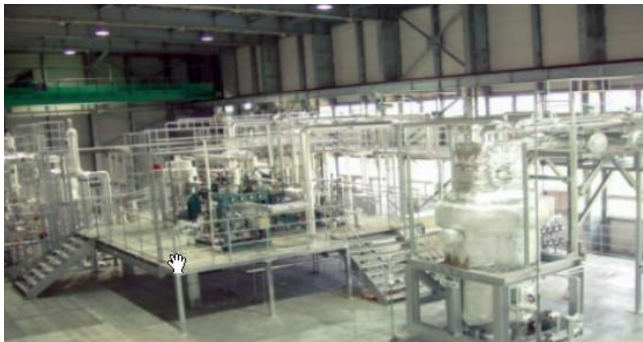
Figura 2-3. Vista general de la planta PCETM de 30 kW.
