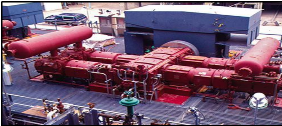
Figura 4 Compresor de múltiples etapas (Toapanta, 2009)
