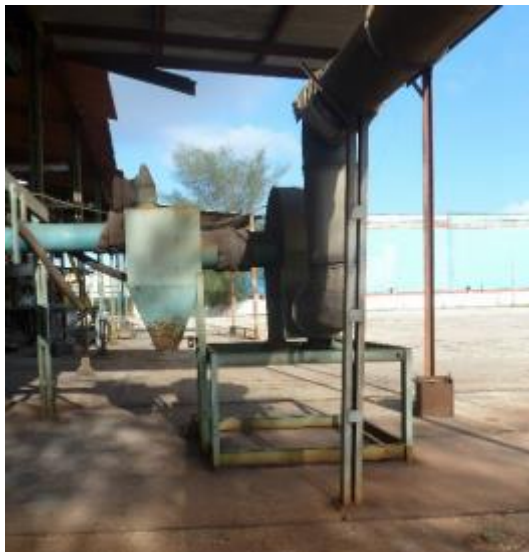
Fig. 1.6 Tubería de escape de los polvos residuales del tambor de limpieza de HOLMECA
