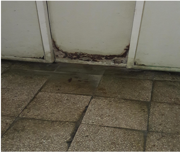
Corrosión por acción de la humedad
