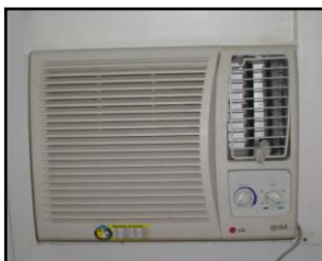
Figura 6: Aire acondicionados Instalados en el área2.
