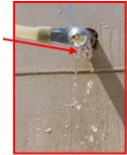
Figura 4. Salidero en la pila del Baño.
