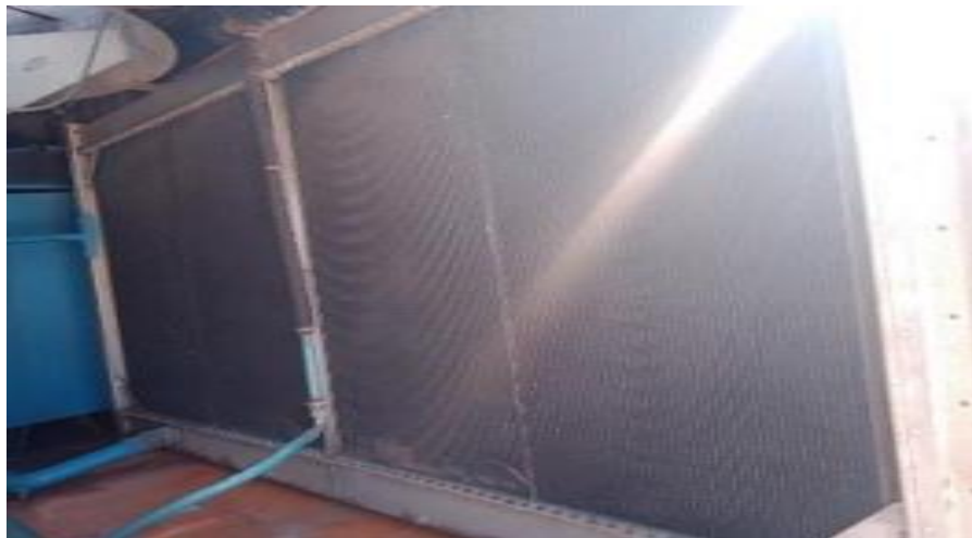
Figura 2.8 radiador de refrigerante del circuito de baja temperatura
