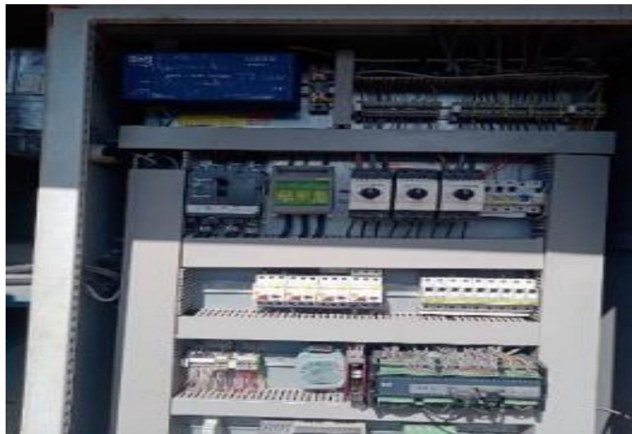
Figura 2.10 panel de control de grupo
