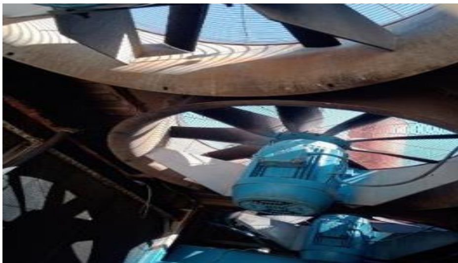
Figura 2.6 Estado de electroventiladores
