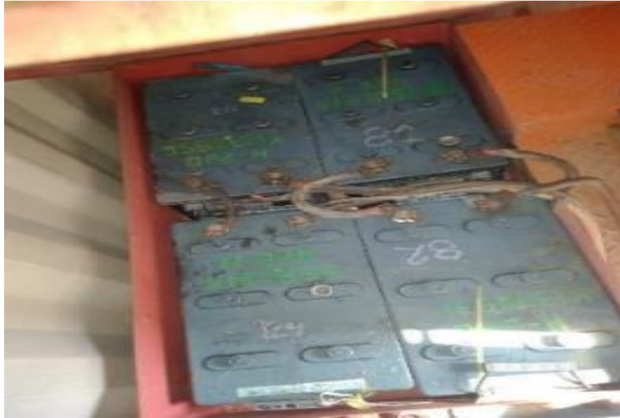
Figura 2.11 cajon de las cuatro baterías de 12 volt
