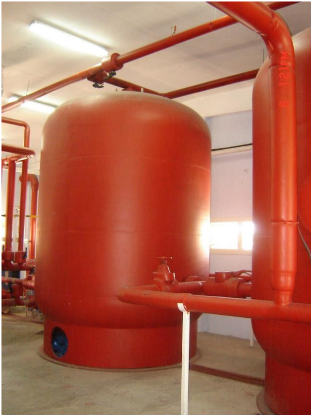
Figura A5.7. Tanques de Almacenamiento de Agua Caliente
