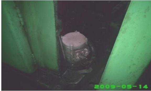
Fig.3 Motor de la bomba de refrigerante.
