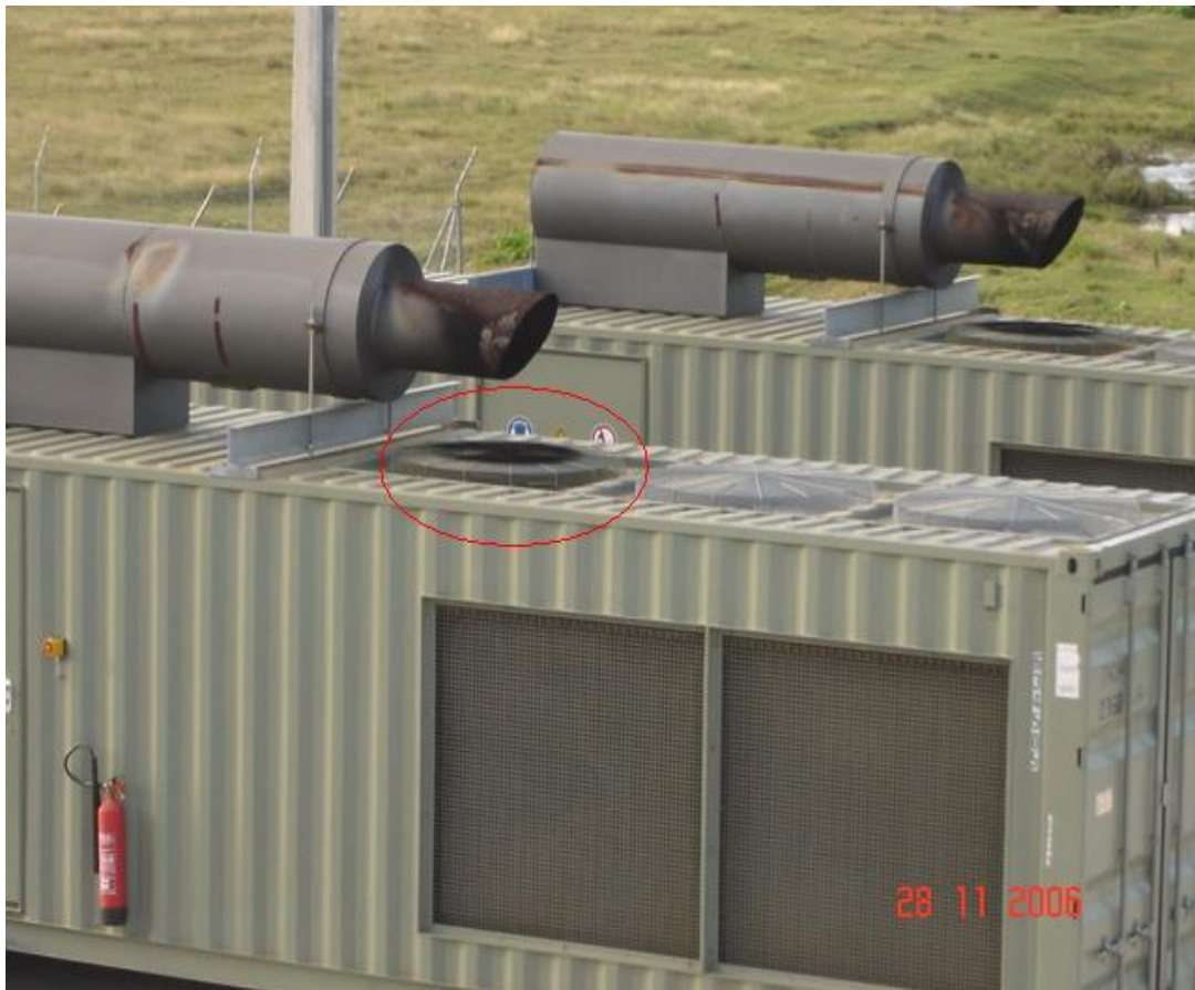
Figura 2.1. Conducto de escape antes de la modificación.
