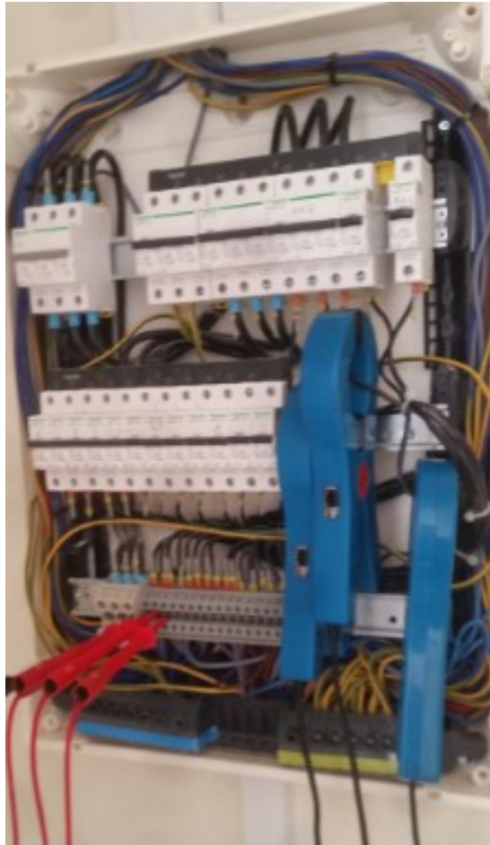
Figura 2.7: Conexiones en la pizarra eléctrica.
