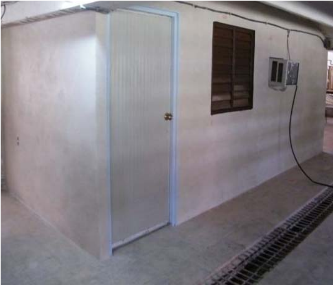
Figura A.3. Local con el equipo de clima (recuperado).
