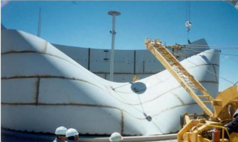
Figura 1.7. Fallo por falta de soldadura. (Fuente: González Dorta, Davinia, 2018)
