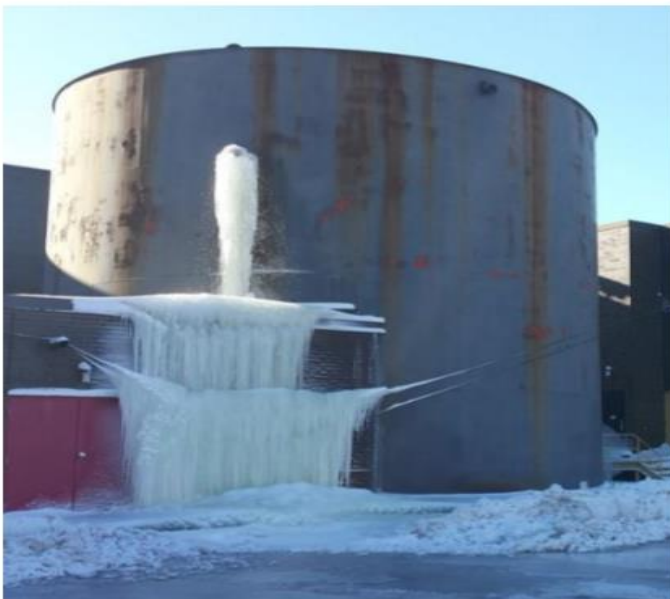
Figura 1.10 Fallo por corrosión. (Fuente: González Dorta, Davinia, 2018)
