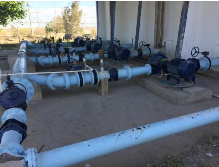
Figura 1.6. Sistema de bombeo en un tanque superficial. (Fuente: Pérez Arbella, O. 2018)
