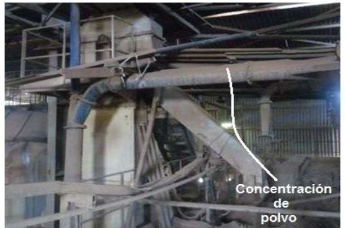
Fig. 8 Elevador de cangilones
