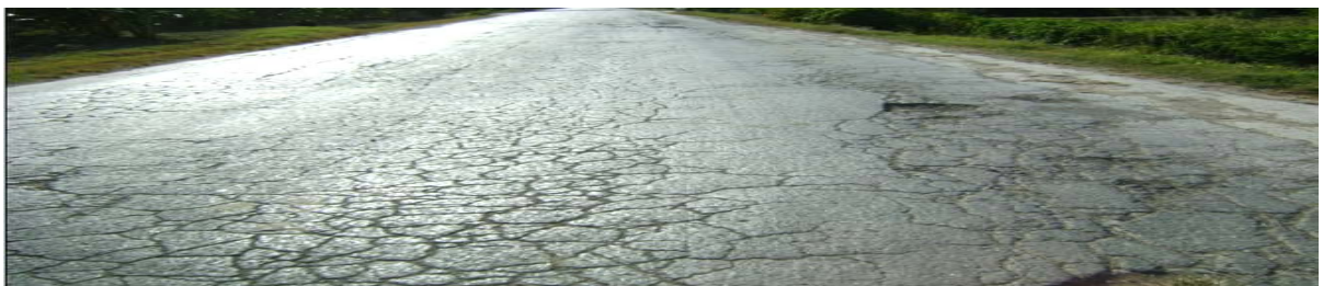
Fig. 11 Red de grieta Deterioro de borde Desintegración a lo largo del borde del pavimento produciendo una diferencia de nivel entre la superficie
