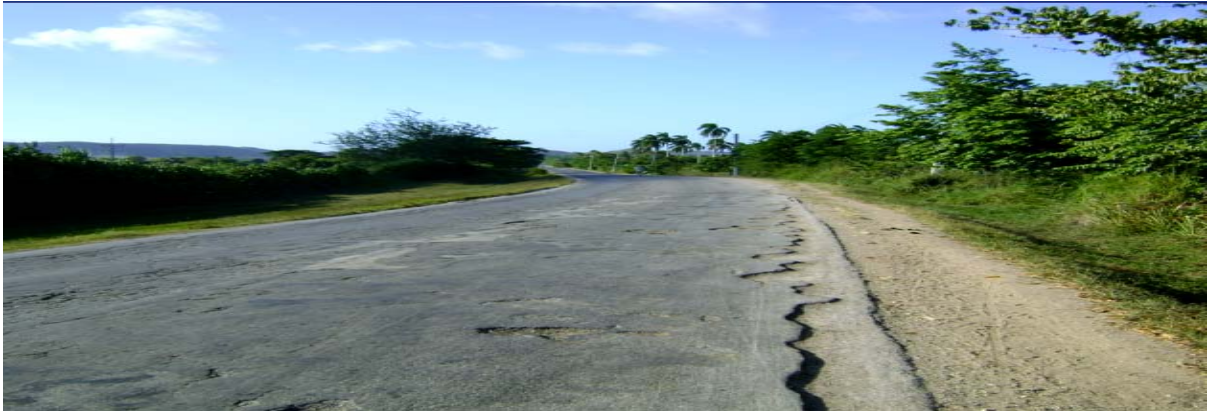
Fig. 10 Deterioro de borde Desintegración a lo largo del borde del pavimento produciendo una diferencia de nivel entre la superficie
