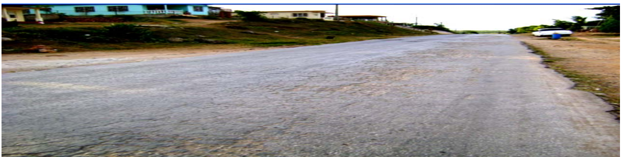
Fig. 3 Desprendimiento de áridos en la parte superior de la capa de rodadura
