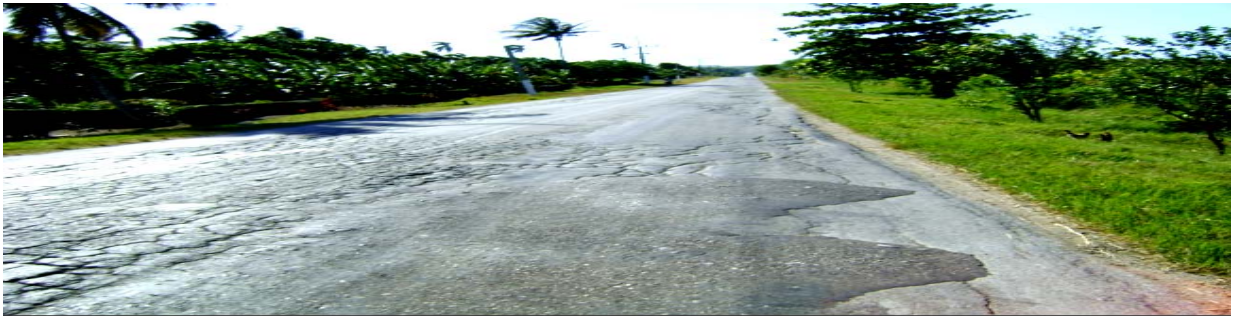
Fig. 1 Red de grieta y Piel de cocodrilo unido a otras fallas múltiples
