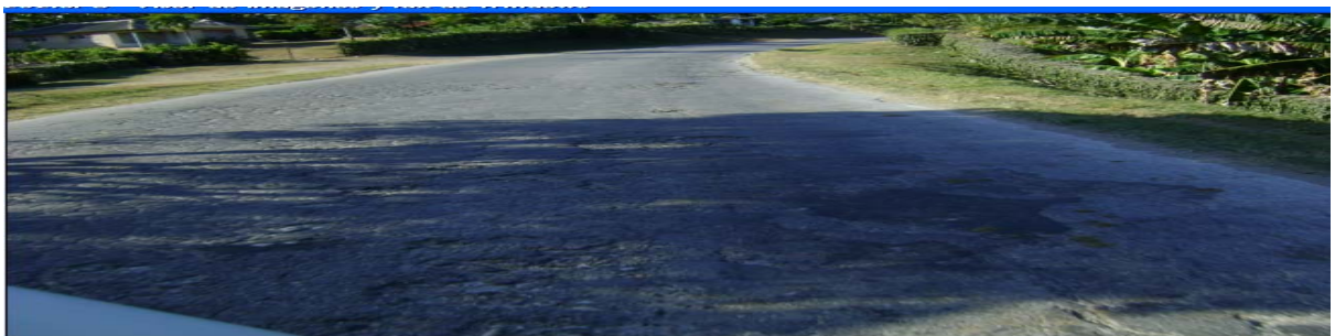
Fig. 8 Red de grieta
