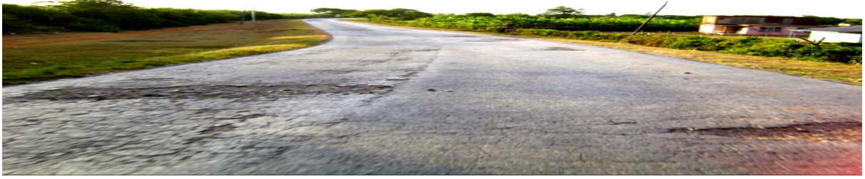
Fig. 5 Deterioro por mala ejecución de reparaciones puntuales
