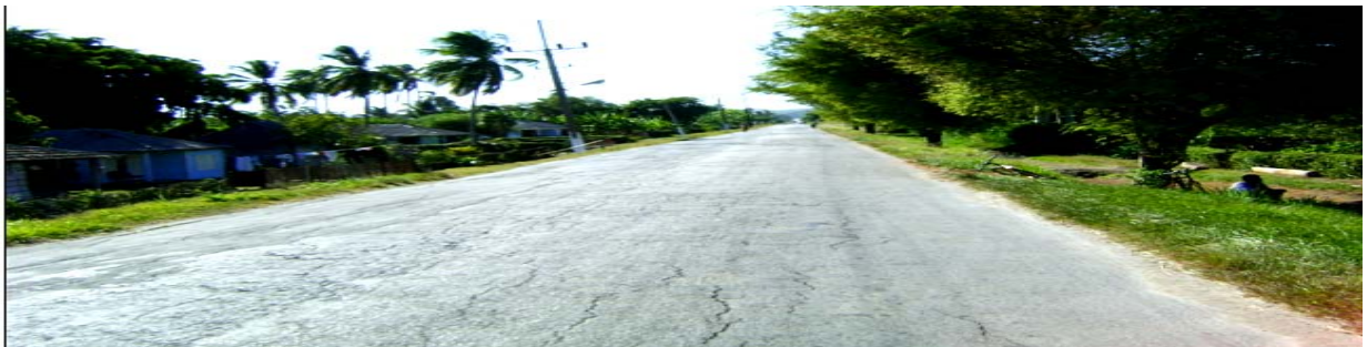
Fig. 2 Red de grieta
