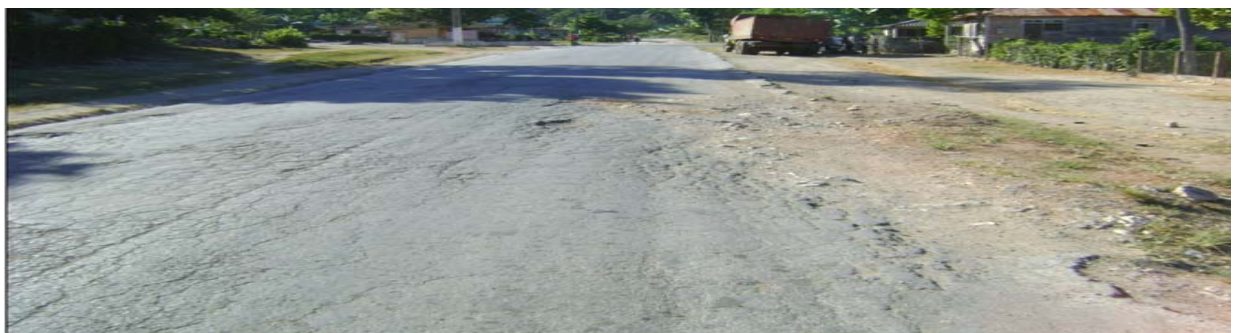
Fig. 4 Deterioro de borde Desintegración a lo largo del borde del pavimento produciendo una diferencia de nivel entre la superficie
