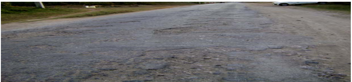
Fig. 12 Rotura total de la carpeta asfáltica
