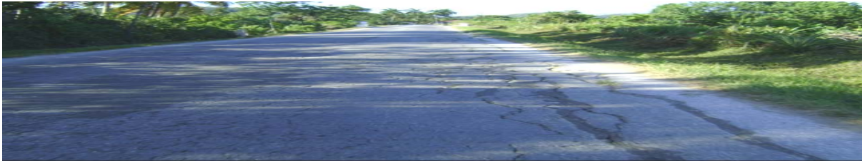
Fig. 6 Red de grieta
