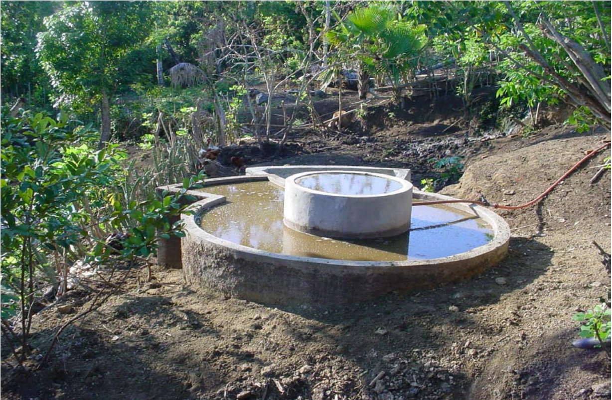
Figura No 2. Planta de Biogás de 23 m 3 montada en despulpadora de café.
