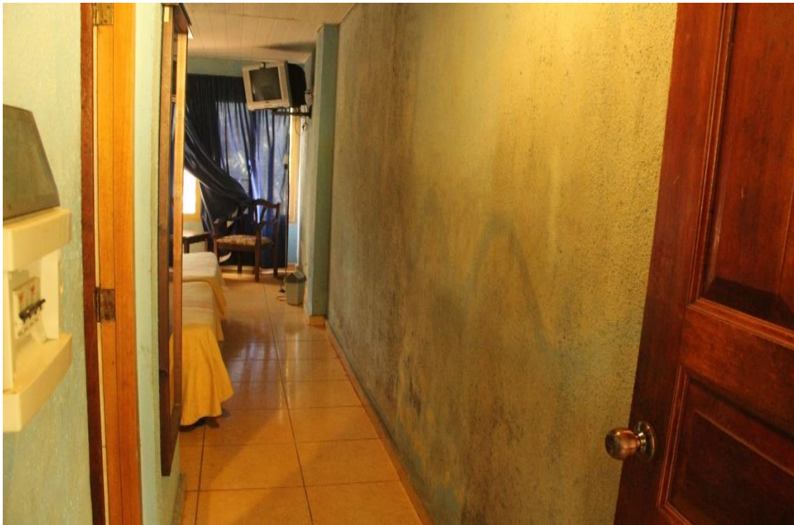
Figura 10: Humedad en paredes.
