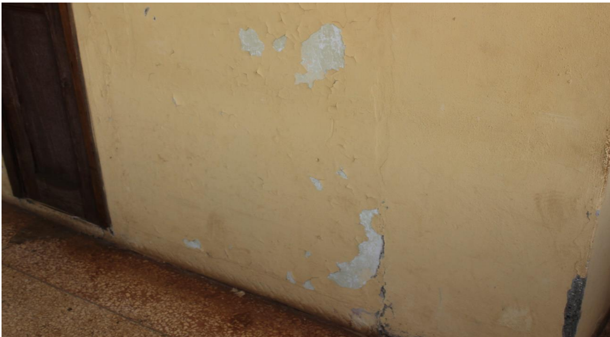
Figura 15: Desprendimiento de pintura en paredes.
