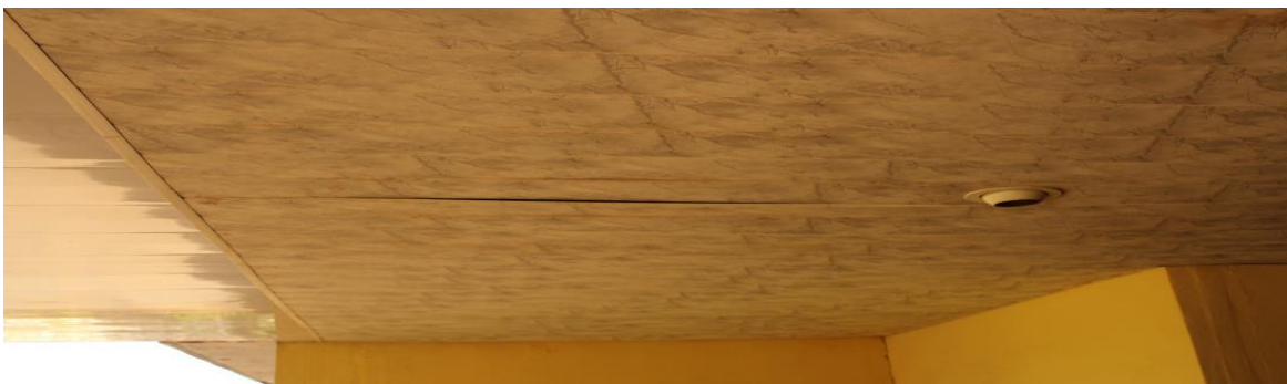
Figura 12: Separación y pandeo del falso techo.
