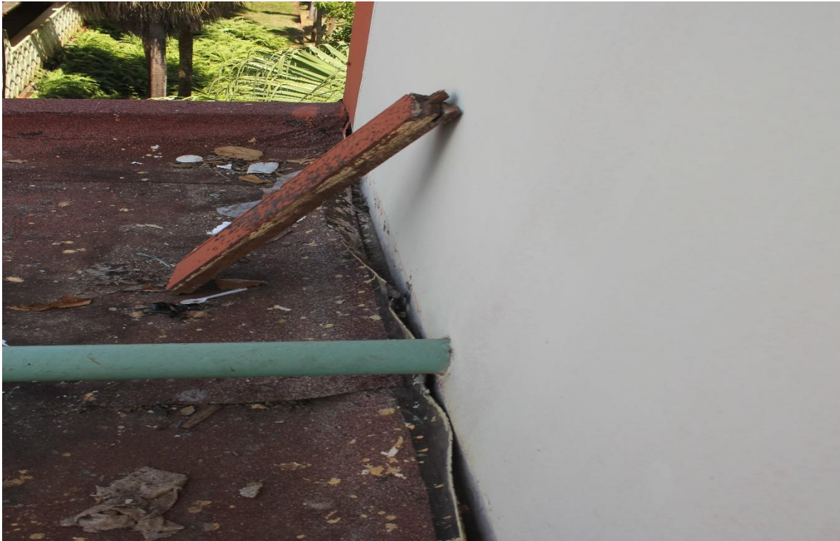
Figura 17: Desprendimiento de la manta impermeabilizante.
