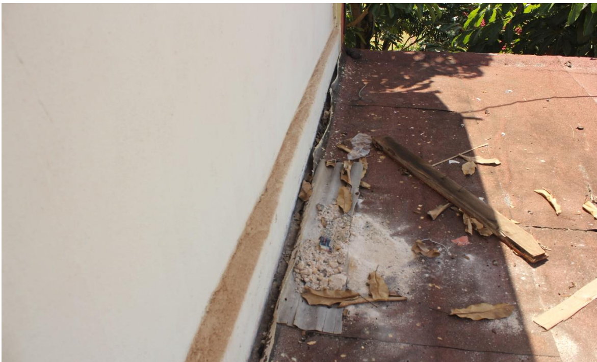
Figura 16: Desprendimiento de la manta impermeabilizante.
