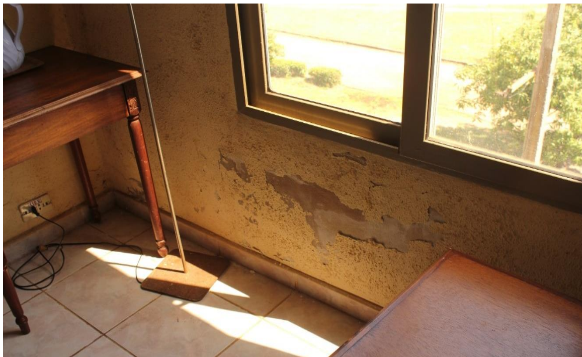
Figura 12: Desprendimiento de pintura en paredes.
