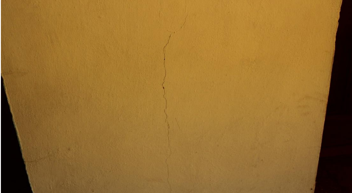
Figura 14: Fisuras en paredes exteriores.
