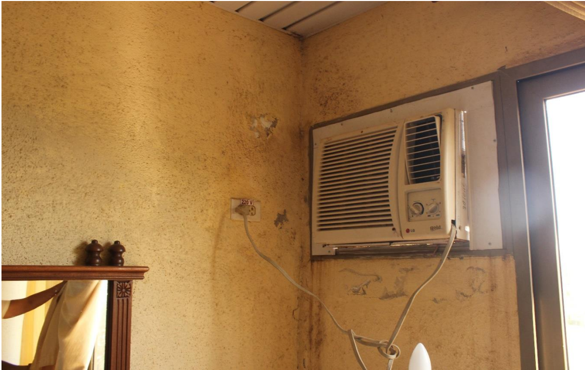
Figura 13: Desprendimiento de pintura en paredes.
