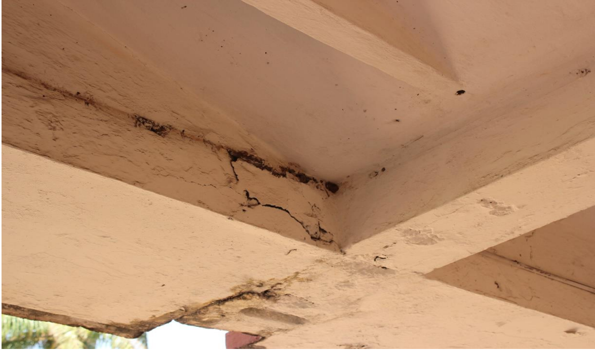
Figura 14: Fisuras en aleros.
