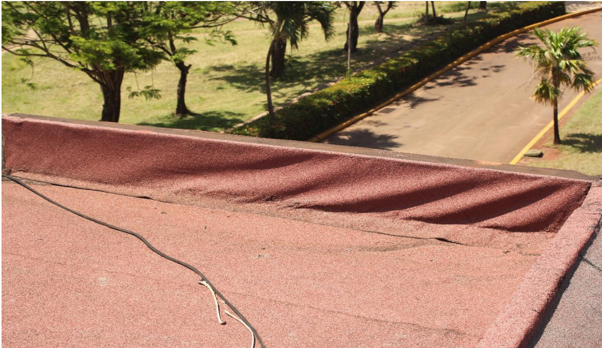
Figura 16: Abultamientos en la manta impermeabilizante.
