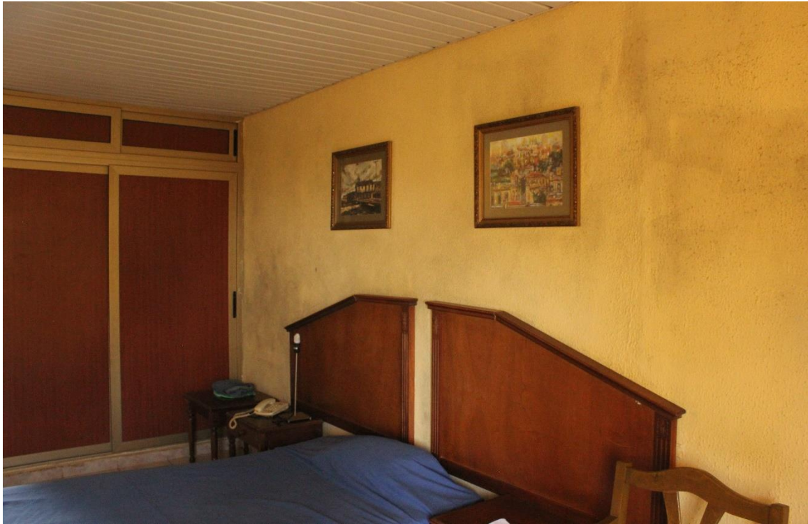
Figura 11: Humedad en paredes.
