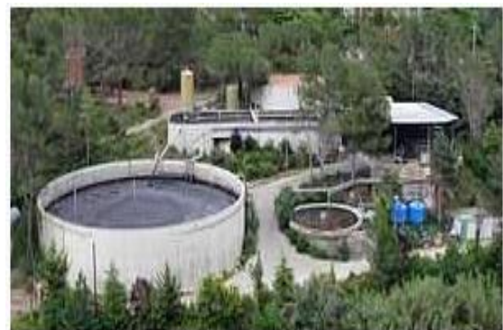
Estación depuradora de aguas residuales en el río Ripoll, en el municipio de Castellar del Vallés, España.
