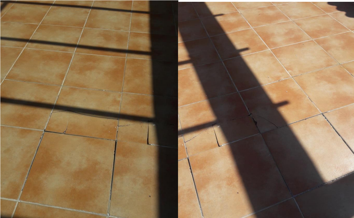
Fig-21: desprendimiento del piso en el bar terraza.
