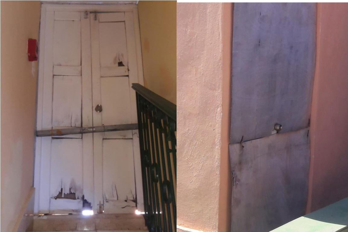
Fig-19: puerta de acceso a la azotea por la escalera de servicio en mal estado.
