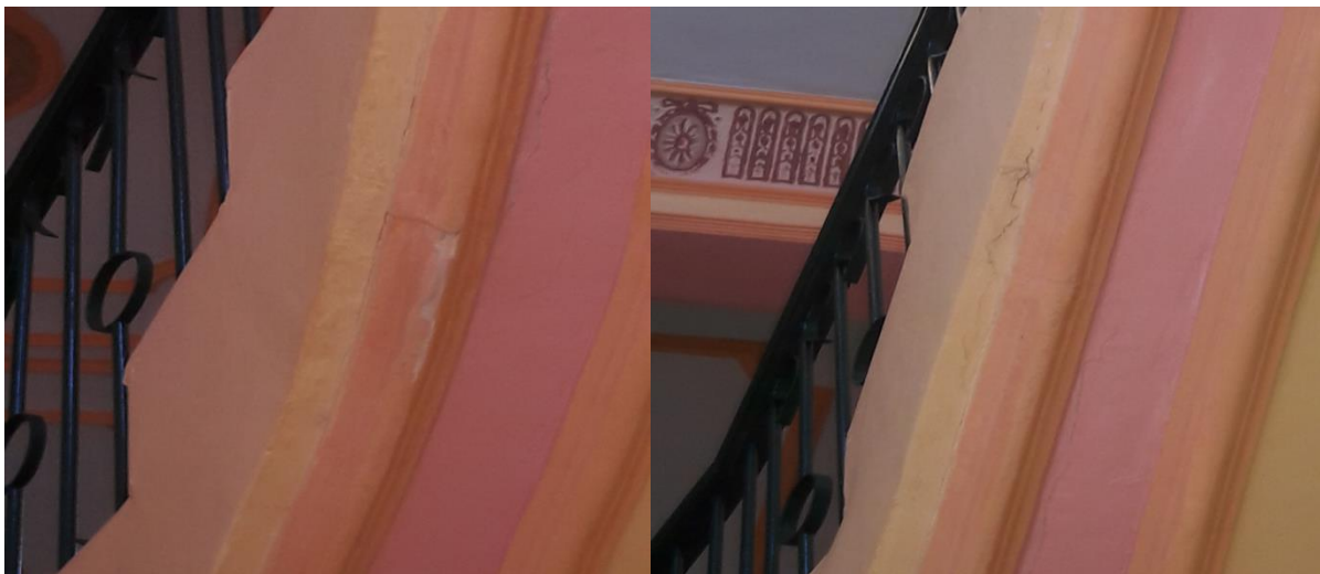
Fig-15: fisuras en la escalera principal que da acceso al 2 nivel
