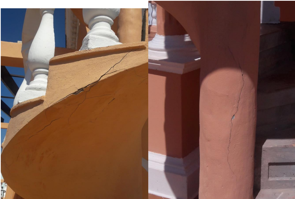
Fig-23: fisuras en la escalera que conduce al mirador
