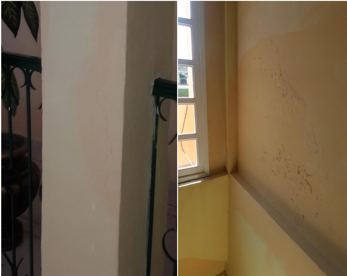
Fig-17: Fisura en columna y presencia de humedad en la escalera de servicio
