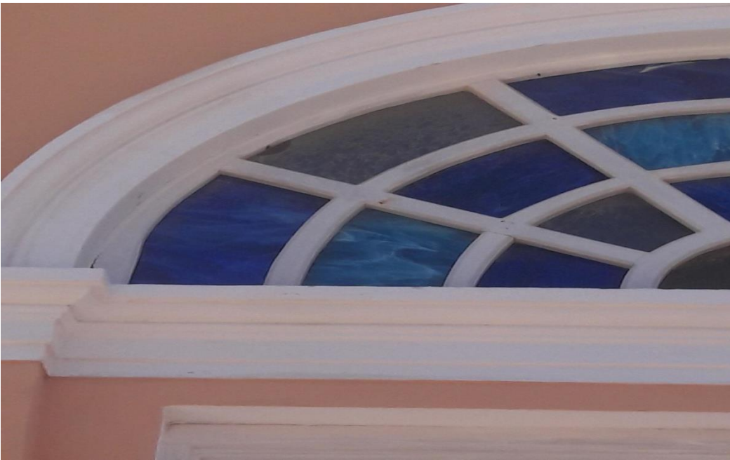
Fig-11: roturas en los vitrales
