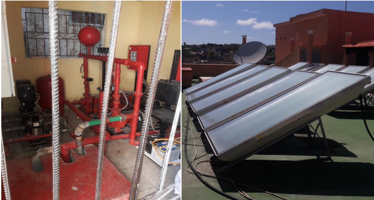
Fig-5: Bomba hidroneumática y Calentadores solares.
