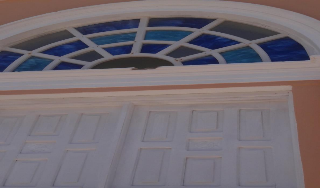
Fig-10: Desprendimiento de materiales
