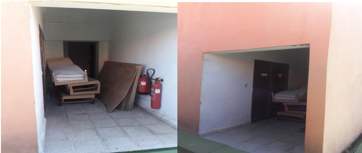
Fig-24: Objetos dejados en la caja de elevadores que en presencia de un fenómeno hidrometeorológicos que genera fuertes vientos se puedan convertir en objetos a la deriva.
