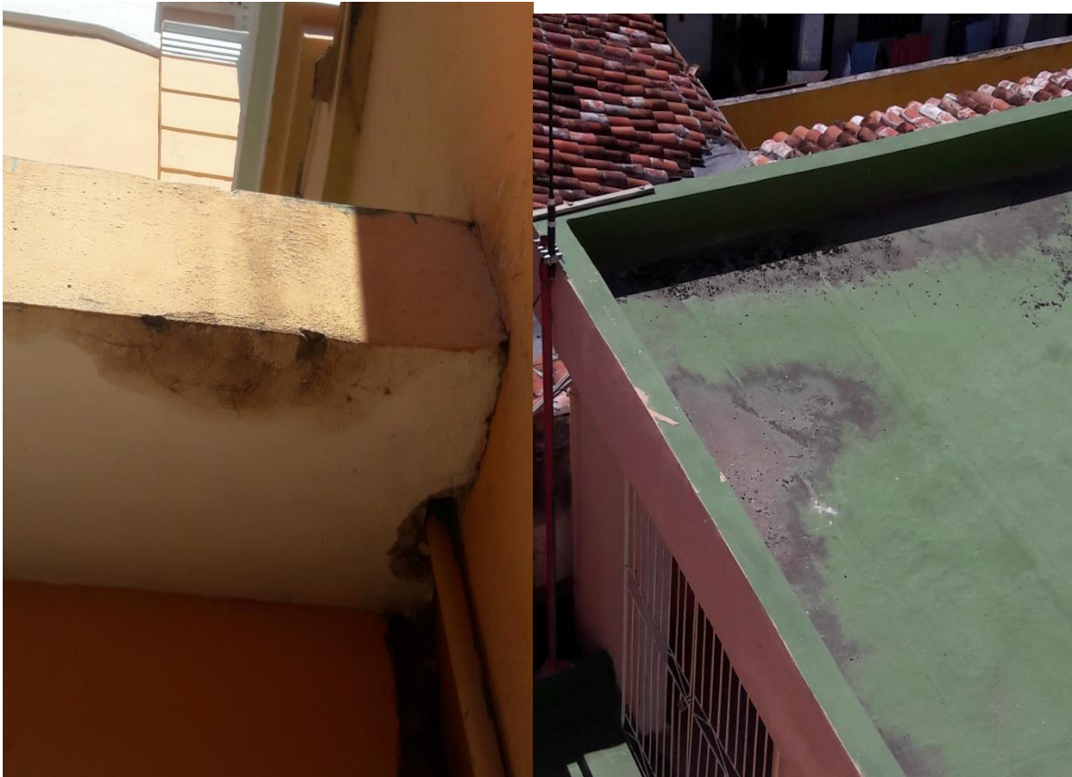
Fig-26: presencia de humedad en la losa de cubierta
