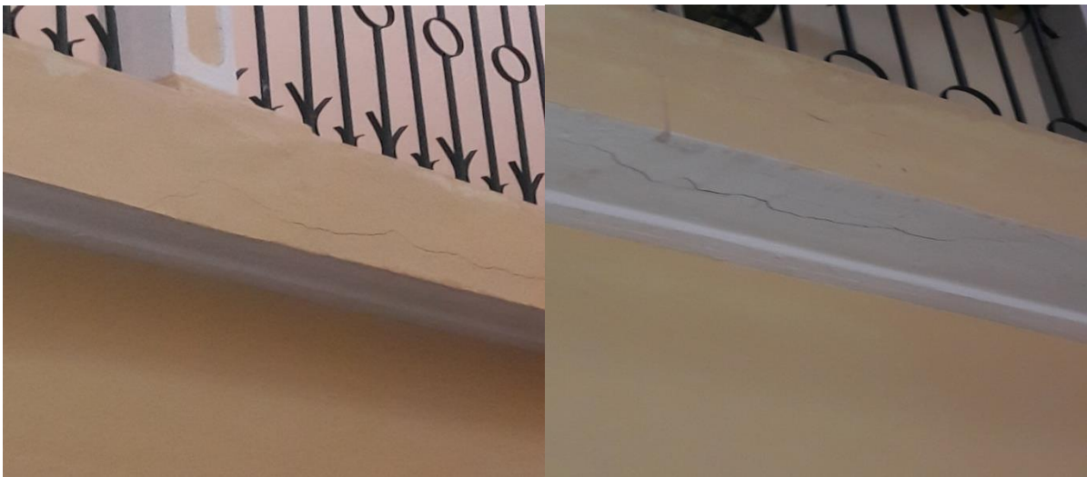
Fig-14: fisuras en la losa entrepiso
