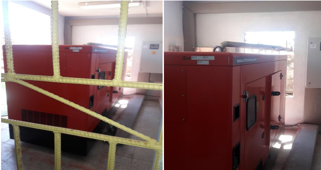
Fig-4: Grupo electrógeno
