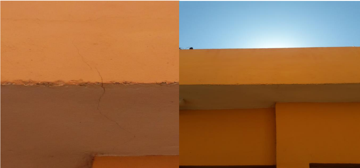
Fig-27: fisura en la losa de cubierta
