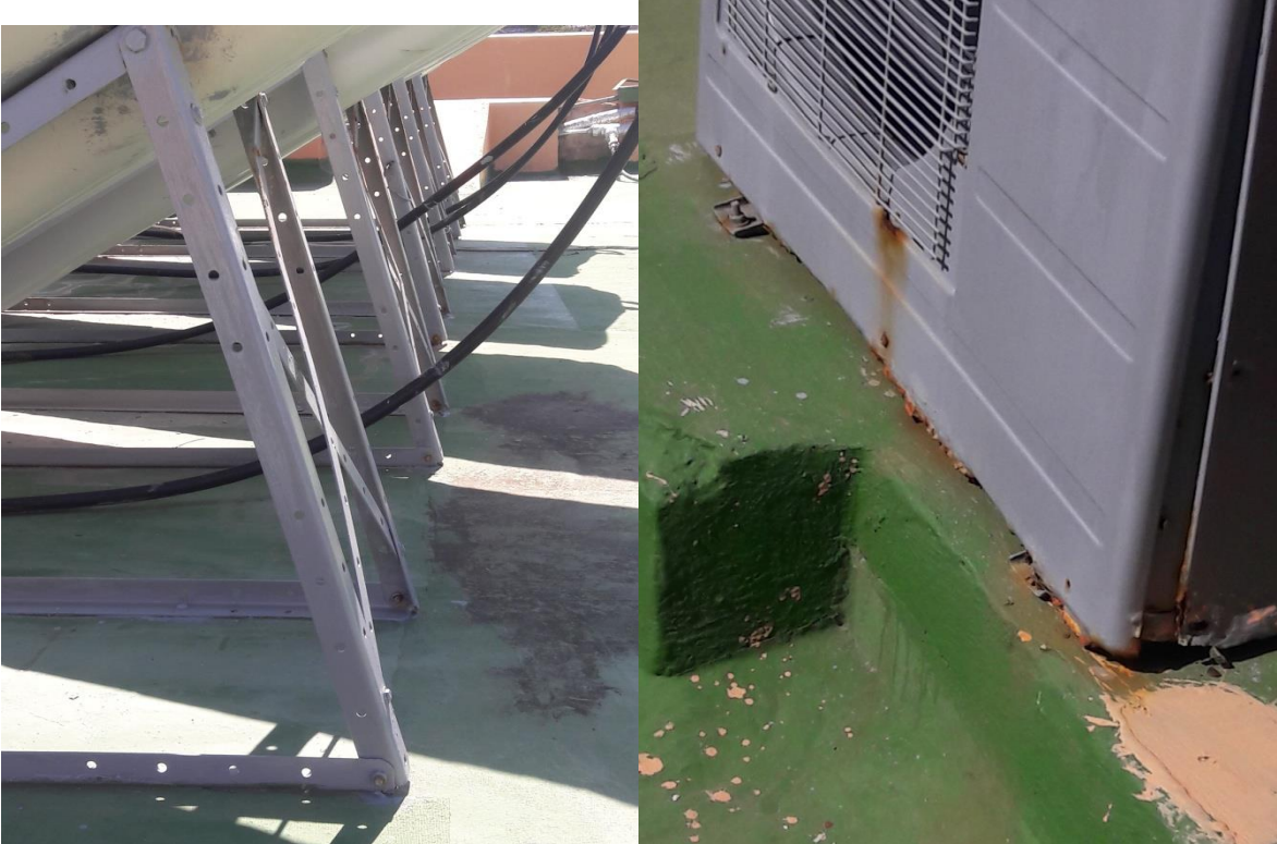
Fig-20: Anclaje de aires acondicionados y calentadores solares deficientes.
