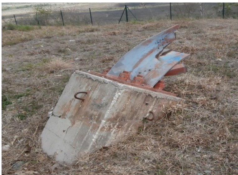
Figura 1.8 Anclaje tipo bloque de la torre fallada. (Foto tomada 31/03/17)
