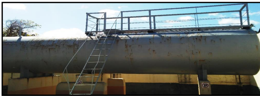
Figura-24: Foto de corrosión de tanque de gas en el Hotel Sol Club Río de Luna y Mares Resort
