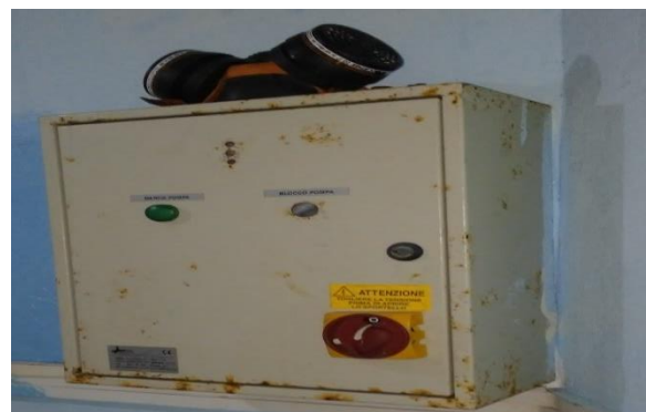
Figura-14: Foto de corrosión localizada en registro eléctrico. Hotel Sol Club Río de Luna y Mares Resort.
