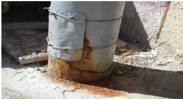
Figura-17: Foto de agrietamiento por corrosión. Hotel Sol Club Río de y Mares Resort.
