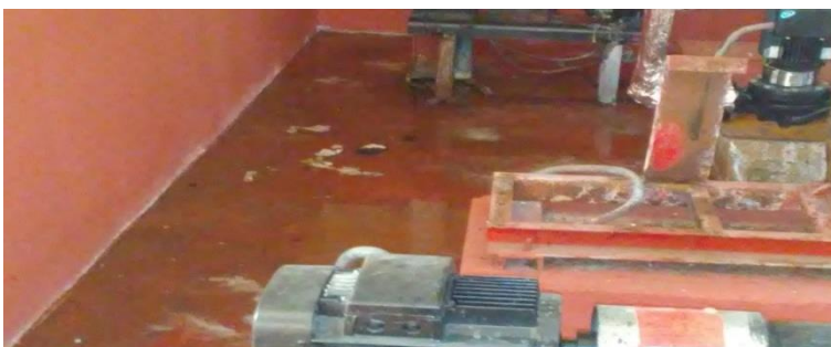
Figura-27: Foto de estanqueamiento de agua en la cámara de piscina en el Hotel Sol Club Río de Luna y Mares Resort
