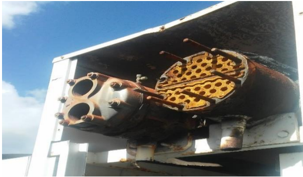
Figura –9: Foto de corrosión general en calderas. Hotel Sol Club Río de Luna y mares Resort.
