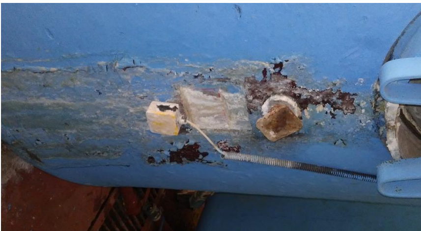
Figura-16: Foto de corrosión microbiológica en caldera. Hotel Sol Club Río de Luna y Mares Resort.
