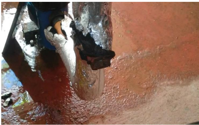
Figura-25: Foto de corrosión y humedad cuarto de climatización Hotel Sol Club Río de Luna y Mares Resort
