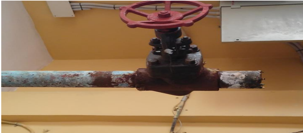
Figuras-12: Foto de corrosión galvánica en instalaciones hidráulicas. Hotel Sol Club Río de Luna y Mares Resort
