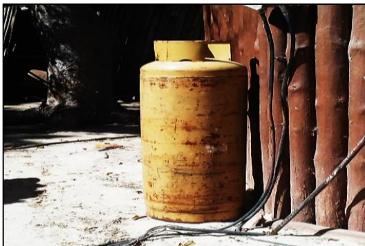
Figura-21: Foto de corrosión en tanque de gas Hotel Sol Club Río de Luna Mares Resort
