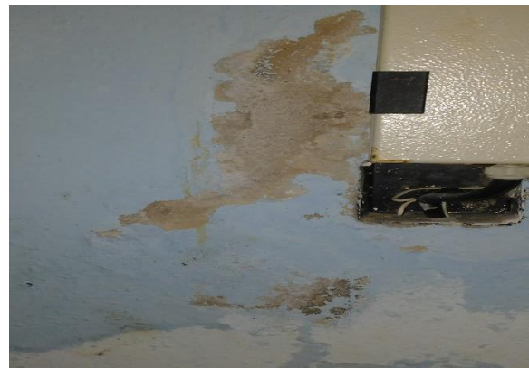
Figura-26: Foto de humedad en pared en el Hotel Sol Club Río de Luna y Mares Resort
