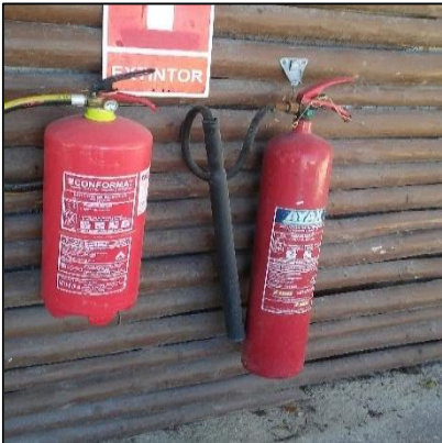
Figura-15: Foto de corrosión por picadura en extintores. Hotel Sol Club Río de Luna y Mares Resort.
