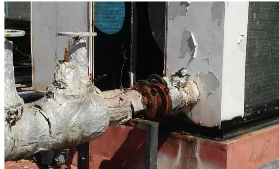
Figura –10: Foto de corrosión general en conducto. Hotel Sol Club Río de Luna y Mares Resort
