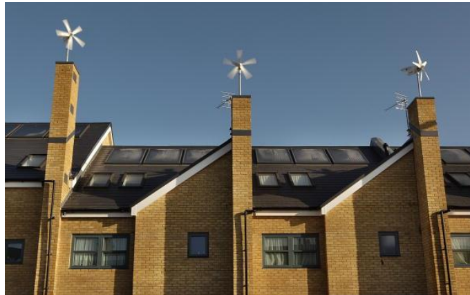
Figura I.9: Aerogeneradores de eje horizontal en azoteas
