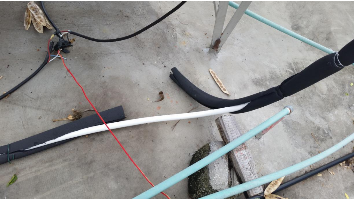
Falta de insulación en tuberías de los calentadores solares
