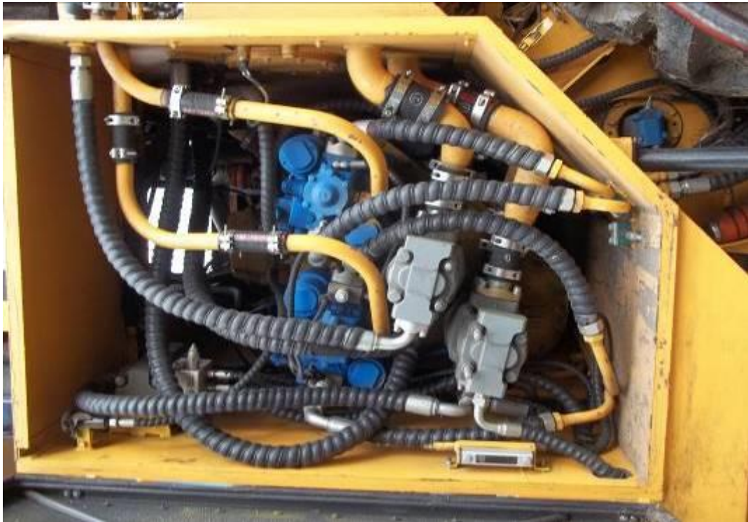
Imagen 1. Caja de bombas y sus conexiones instalada al motor de combustión interna. Fuente: Tomada por el autor.
