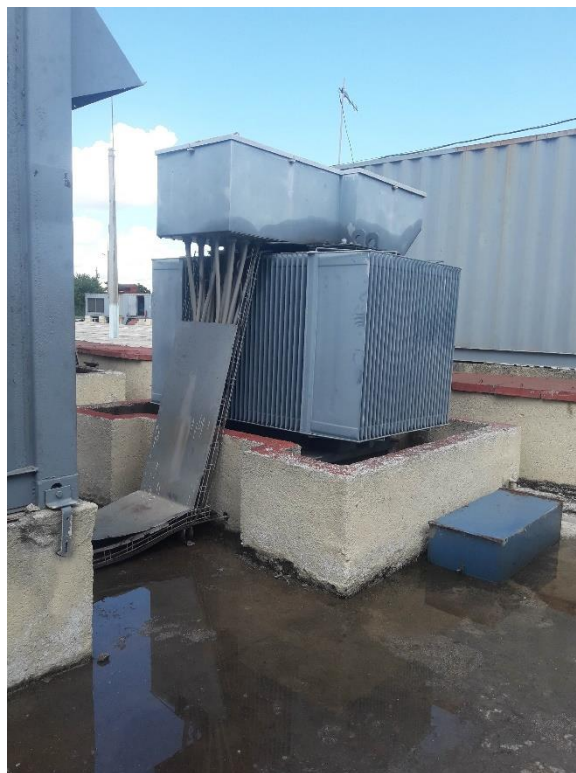
Anexo 3. Transformador del grupo electrógeno.
