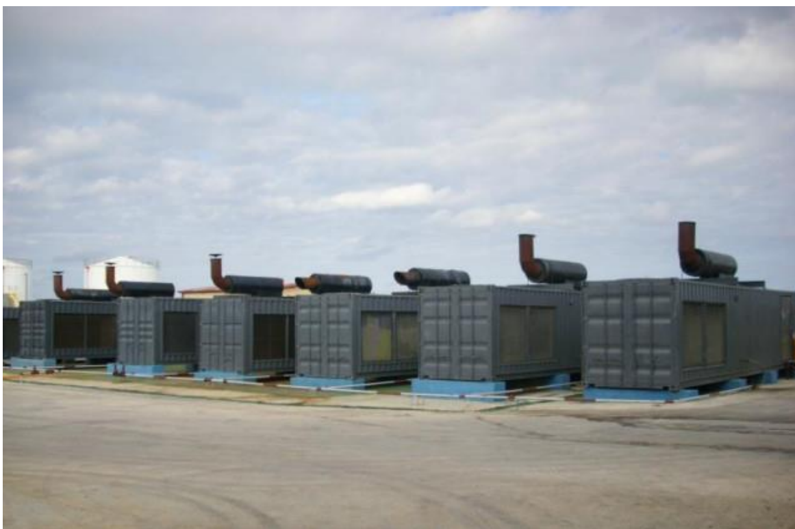
Anexo 6. Batería conformada por Grupos Electr6genos. Fuente: (Torna del Rio, 2014).
