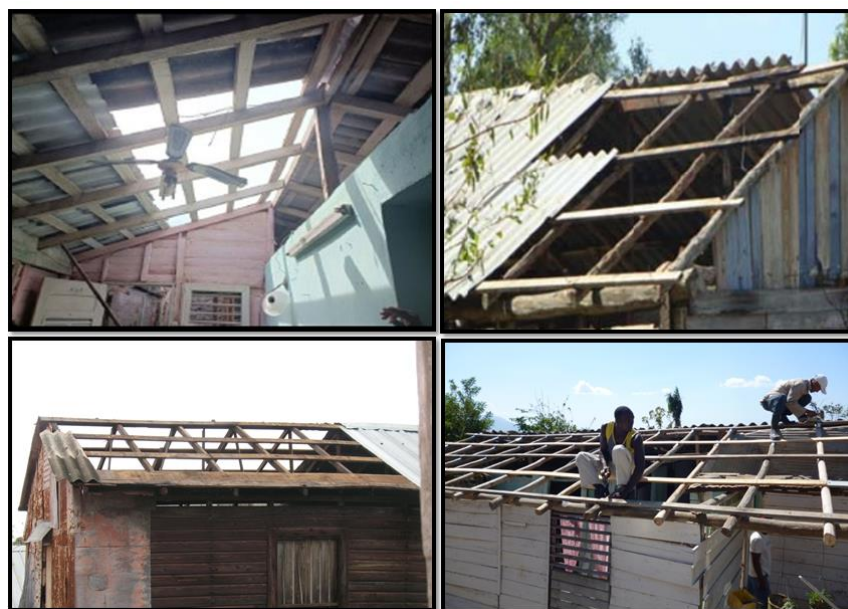
Figura 1.13 Imágenes de cubiertas ligeras dañadas por el paso de fuertes vientos durante ciclones tropicales. Fuente: Figueredo, 2013
